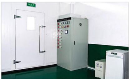
加工位空壓機控制櫃 Electric-compressor air
