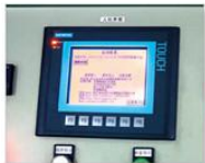
控制櫃門子控制系統 Electric control system
